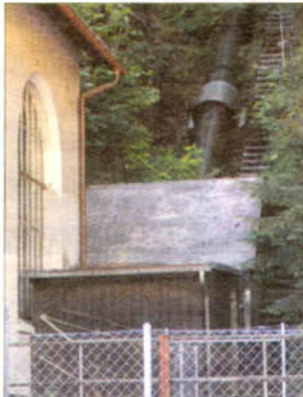
Bürs Kraftwerk Getzner: Die Druckleitung beim Alvierwerk in Bürs.
